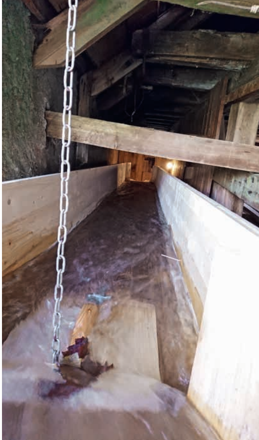
16 Der hölzerne Kanal, welcher den Mühlebach aufs Wasserrad der Öli führt. Wird die Klappe (im Vordergrund) mit der Kette angehoben, fällt das Wasser vor dem Rad in die Tiefe, die Öli steht still.
