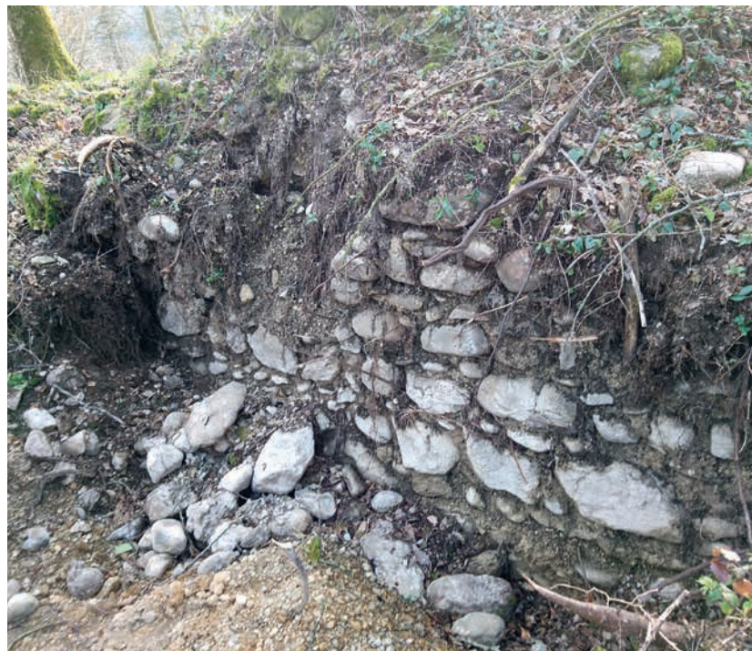
2 Ein Sturm legt die nördliche Aussenmauer frei. Das Mauerwerk ist unbeschädigt und wurde wieder zugeschüttet.
