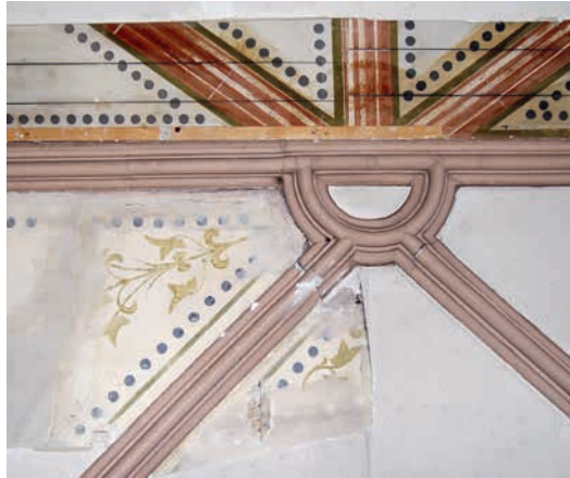
11 Leuggern. Pfarrkirche St. Peter und Paul. Befundfenster im Bereich der Mittelschiffdecke mit Resten der 1906 von Eugen Steimer konzipierten Deckenmalereien. Foto: DPAG, Stefan Buess, 2004.
